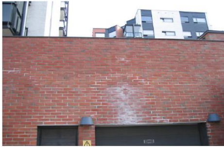
Kuva 1 Vuotokohdat ovat näkyvissä tiiliseinässä oven Yläpuolella.
