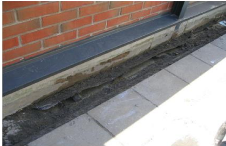
Kuva 3 Koko muurin alue on avattu ja todettu, että kermieristykset ovat täysin irti toisistaan ja alustasta.
