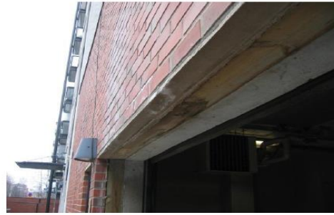
Kuva 2 Vuotoa on myös autohalliin johtavan oven päällä.
