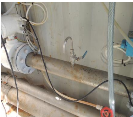
Kuva 24. Tulevan veden näytteenottohana kiekkosuodatuskoelaitteistossa.
