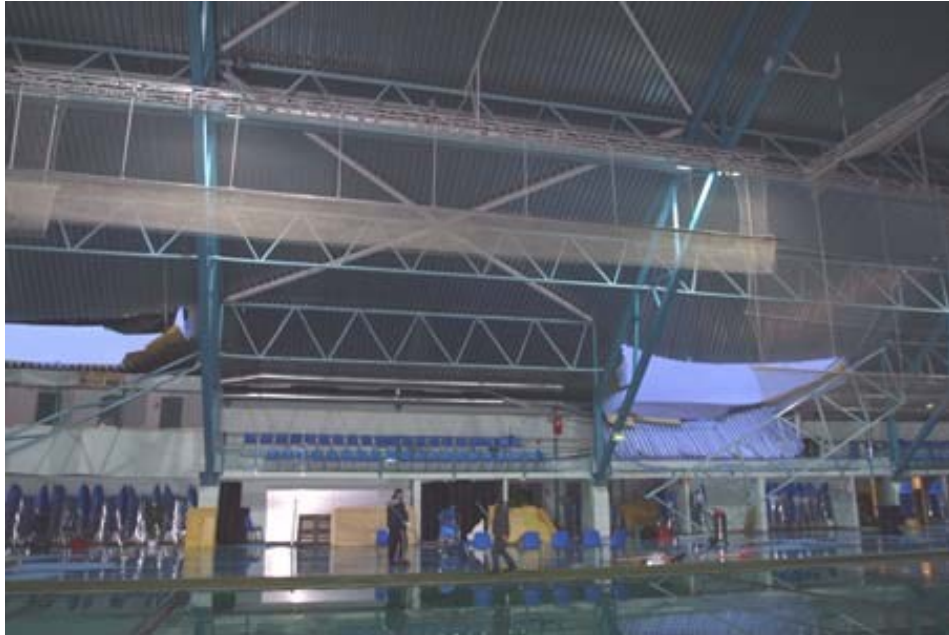
Kuva 6. Sortunut katto jäykistysristikon molemmilla puolilla. (Kuva: Onnettomuustutkintakeskus 2003)
