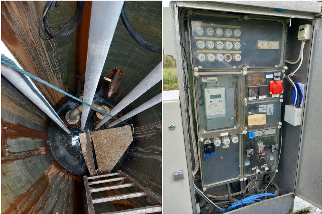
Kuva 6. Pumppaamon 5016 imusäiliö ja sähkökeskus
