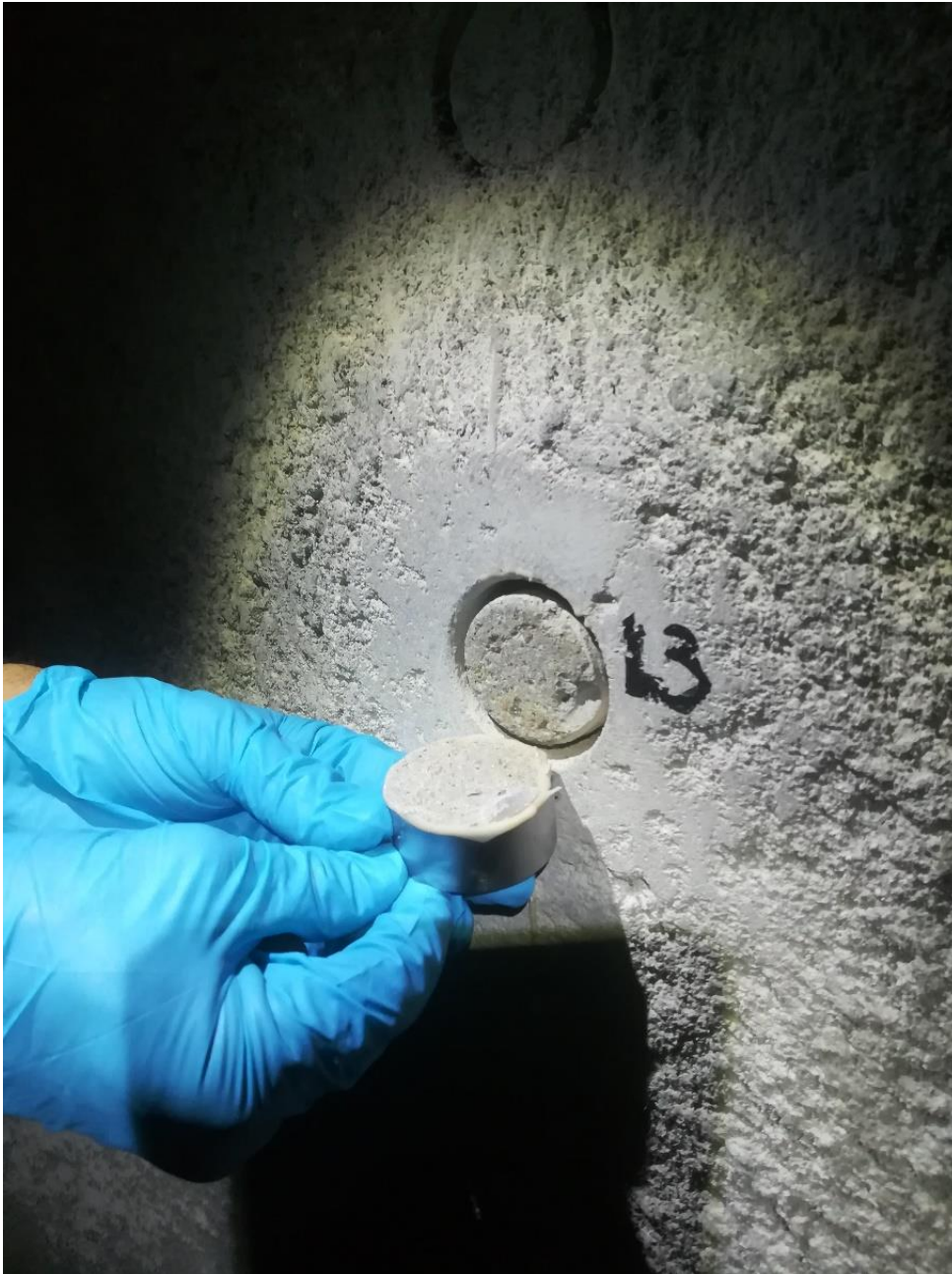
Kuva 32. Ruiskubetonin murtuminen ruiskubetonilieriön pinnasta 28 vuorokautta vanhasta ruiskubetonista alueen 2 tartuntalujuusmittauksessa.
