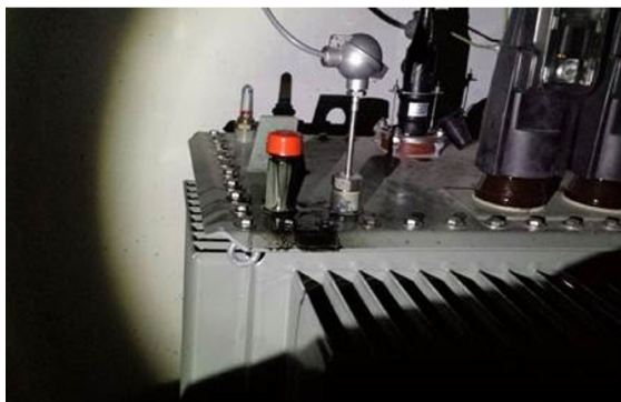
Kuva 16 Jakelumuuntajan sisäisen oikosulun aiheuttama öljyvuoto [40]
